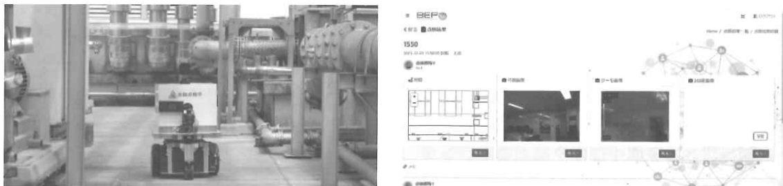
図1 BEPサーベイランス (施設内を自動巡回するAGV (左) と管理画面 (右))
