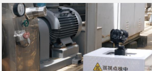
AGV搭載カメラにより計器類を撮影
